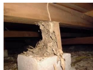
シロアリによる被害
